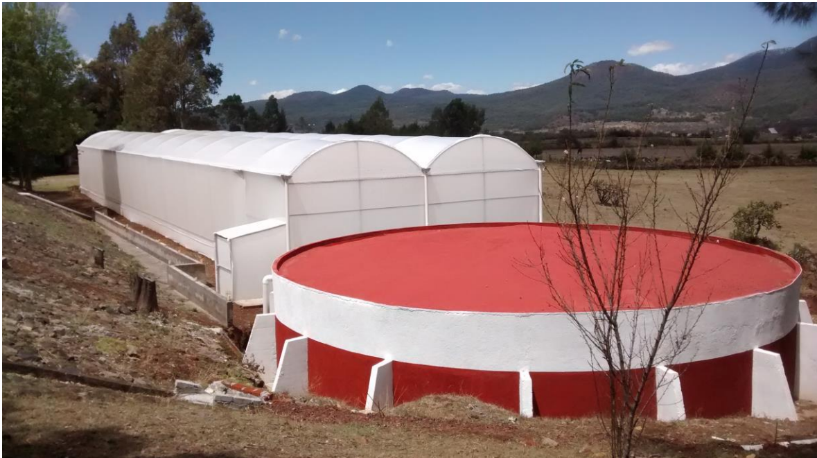
Sistema para captar agua de lluvia. Al frente, el tanque de almacenamiento y, al fondo, el invernadero.
