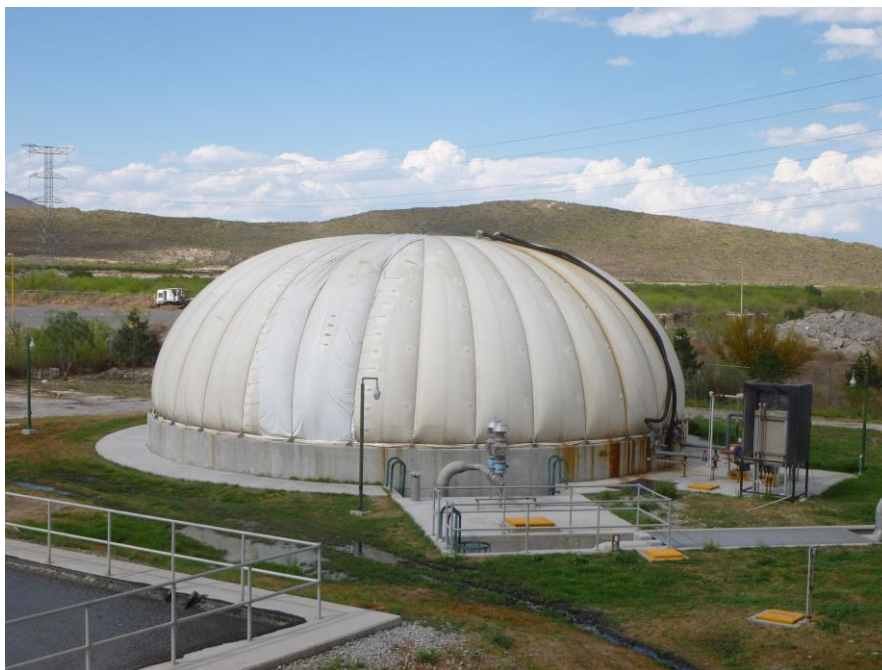
Almacenamiento de biogás, PTAR principal, Saltillo, Coahuila.
