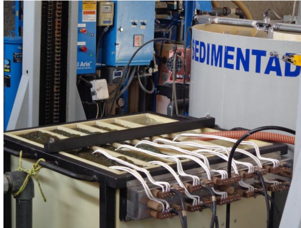
Reactor de electrocoagulación.
