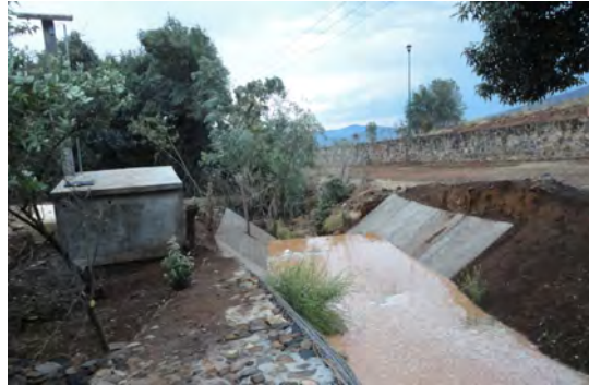
Evento de escurrimiento sobre canal Parshall.
