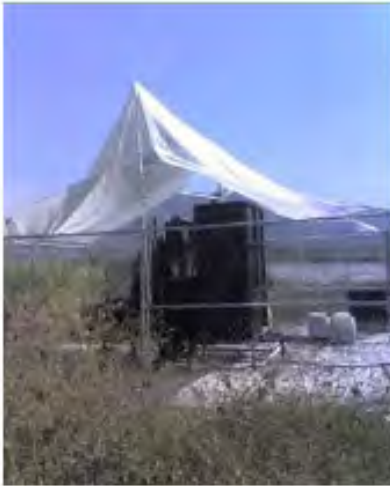
Planta instalada en la granja porcícola de Jojutla, Morelos.
