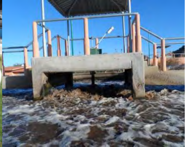
PTAR Nopoló, Loreto, Baja California Sur.
