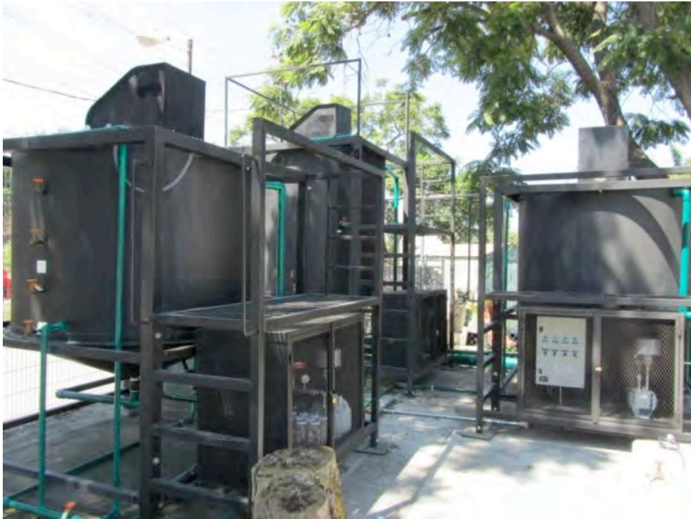
Prototipos experimentales instalados en la planta de tratamiento de aguas residuales municipales de El Texcal, Jiutepec, Morelos.
