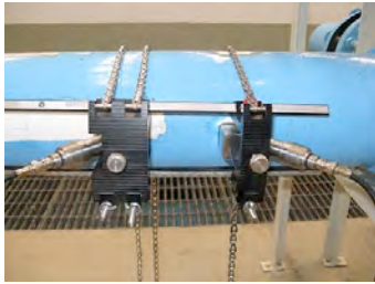
Medidor de velocidad del agua Panametrics.
