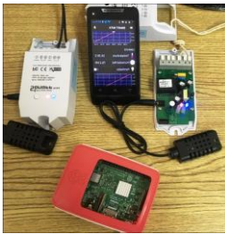
Sistema de monitoreo de temperatura y humedad relativa en los Centros de Datos del Instituto.
