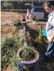
Abastecimiento de agua potable mediante el pozo ubicado en Vicam (pueblo yaqui), Sonora. Concentración de arsénico cuatro veces, por encima de la NOM-127-SSSA1-1994, modificada en el año 2000.
