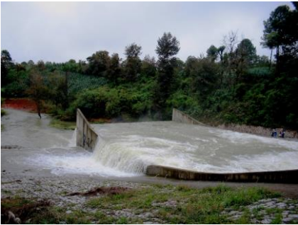
Problemas operativos del vertedor actual, 2005.
