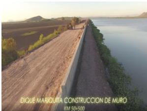
Sobreelevación del dique Mariquita.
