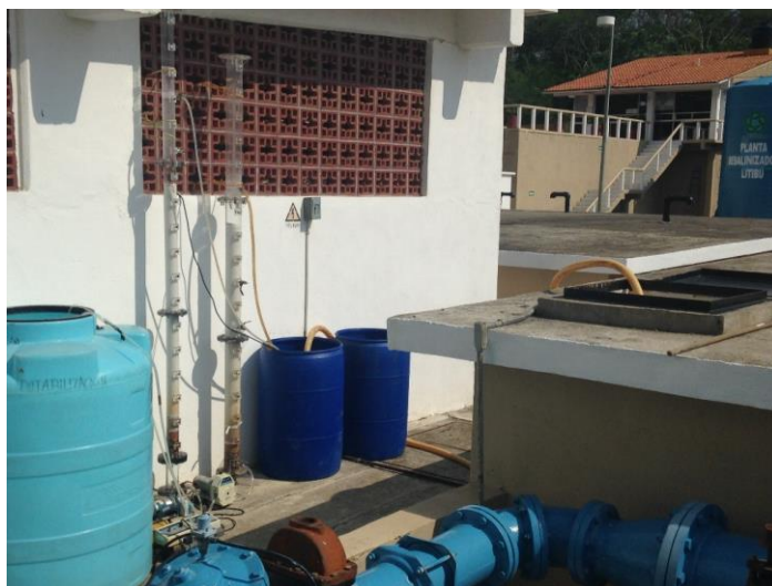
Pruebas de remineralización en la planta desalinizadora Litibú
