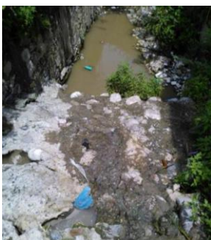
Descarga de aguas residuales al río Tomatal.
