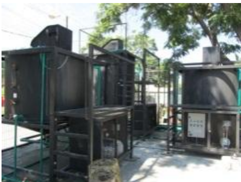
Sistemas BIOSTAR-IMTA instalados en la PTAR de El Texcal, para su evaluación.
