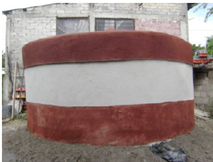
Cisterna de captación pluvial en la colonia Ampliación Miguel Hidalgo, Xochitepec.
