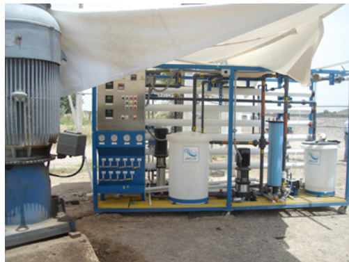
Unidad de nanofiltración.
