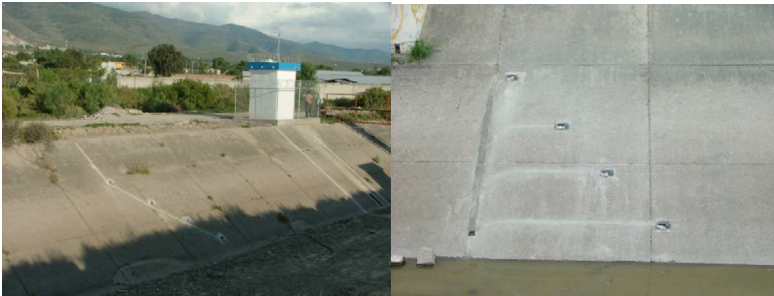
Instalación de tiempo de travesía en el DR 030 Valsequillo, Puebla.
