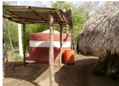
Cisterna de 11,000 litros y sistema de captación en Malilijá.
