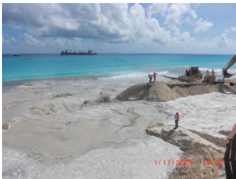
Inicio de los trabajos de vertido de arena en la isla barrera de Cancún el 1º de noviembre de 2009.
