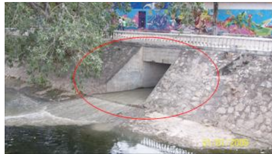
Vista de una descarga de agua residual al río Sabinal.
