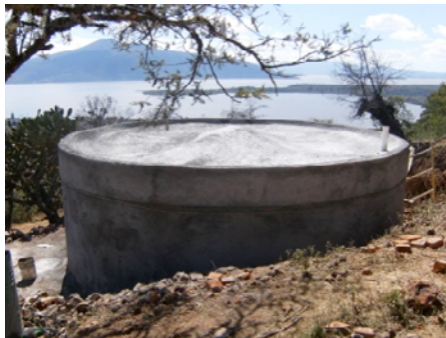
Cisternas comunitarias (100,000 litros) en San Jerónimo Purenchécuaro.
