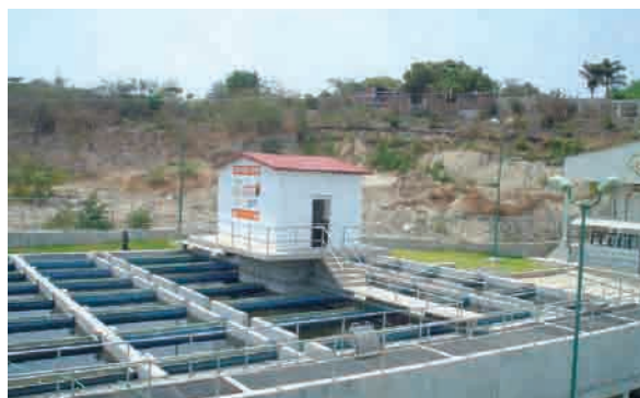
Unidad de floculación-sedimentación de la potabilizadora
