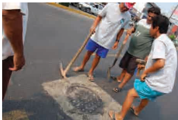
Falta de equipo de protección.
