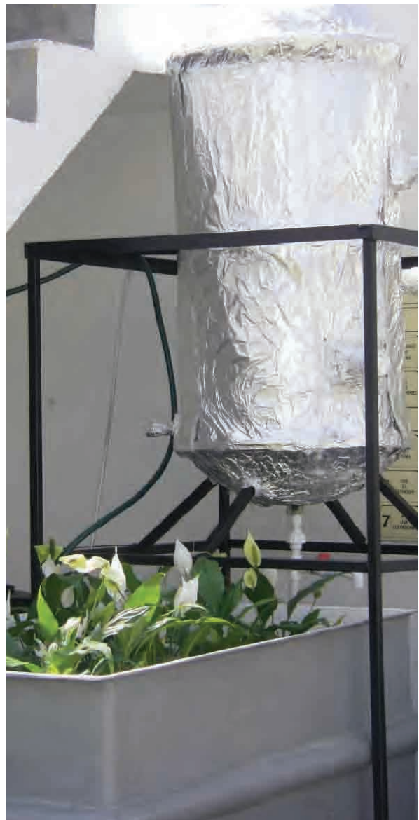
Tratamiento de aguas residuales domiciliario: Biofiltro+humedal.
