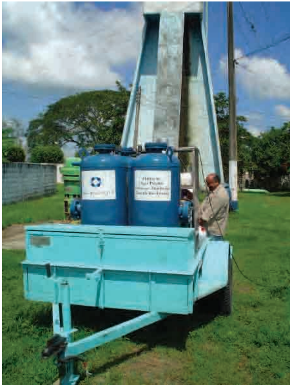
Planta potabilizadora instalada en Carlos A. Carrillo, Veracruz.
