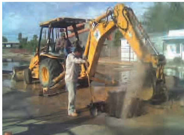
Fuga ubicada en Av. Guadalupe Victoria con Calle 15.
