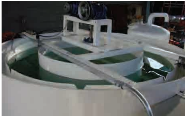
Vista de la unidad de floculación-sedimentación, Jiuতেpec, Morelos.
