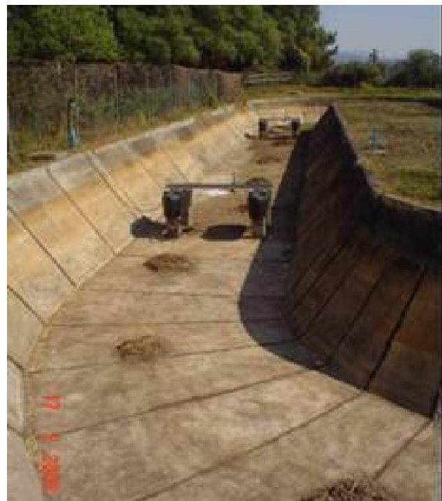
ZANJA DE OXIDACIÓN FUERA DE SERVICIO EN LA PLANTA DE TRATAMIENTO DE AGUAS RESIDUALES LAS GARZAS, PÁTZCUARO, MICHOACÁN
