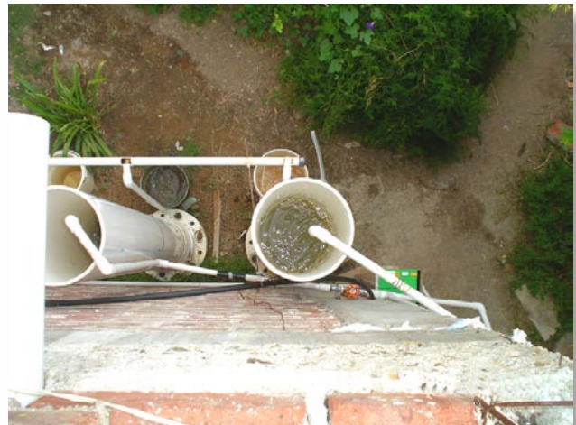
VISTA DE LA PRIMERA COLUMNNA (FILTRRO GRUESO)
